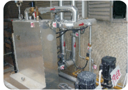
圖：3.19 高溫冷凝水回收系統
